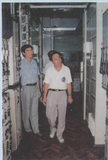
微波通信机房
