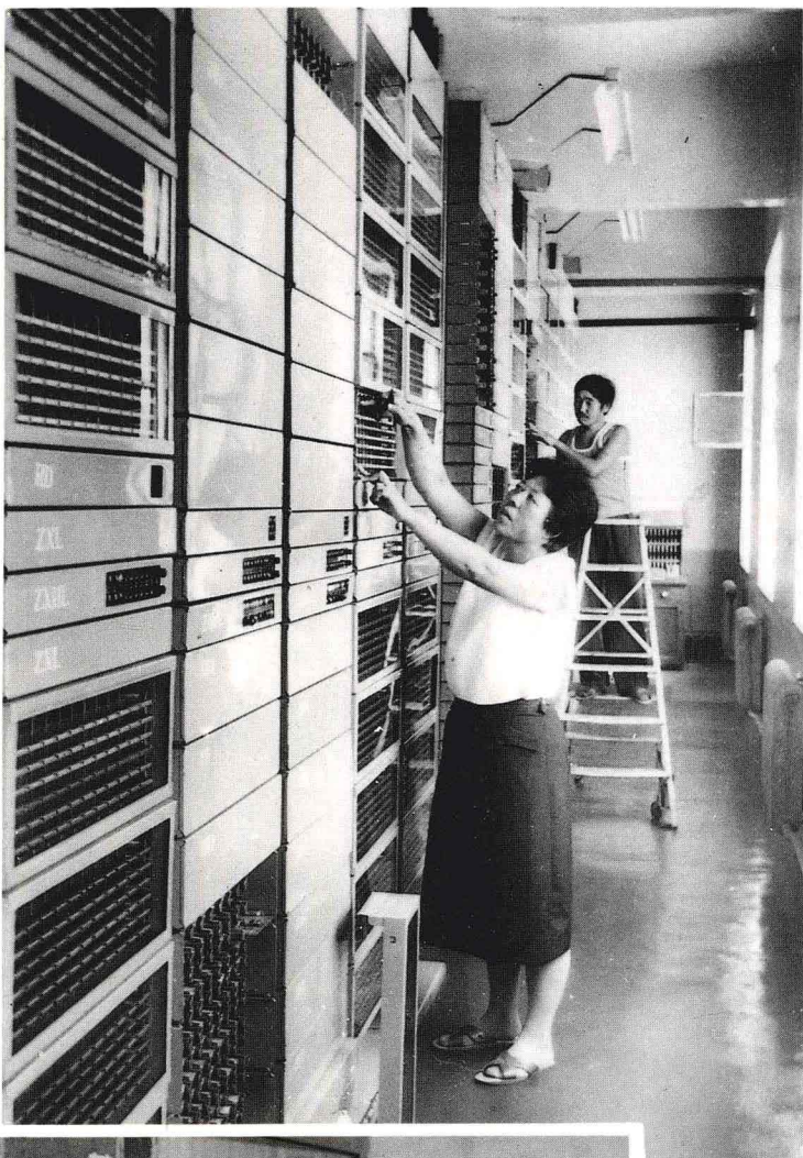
HJ—921 1000门纵横 制自动电话交换机房
