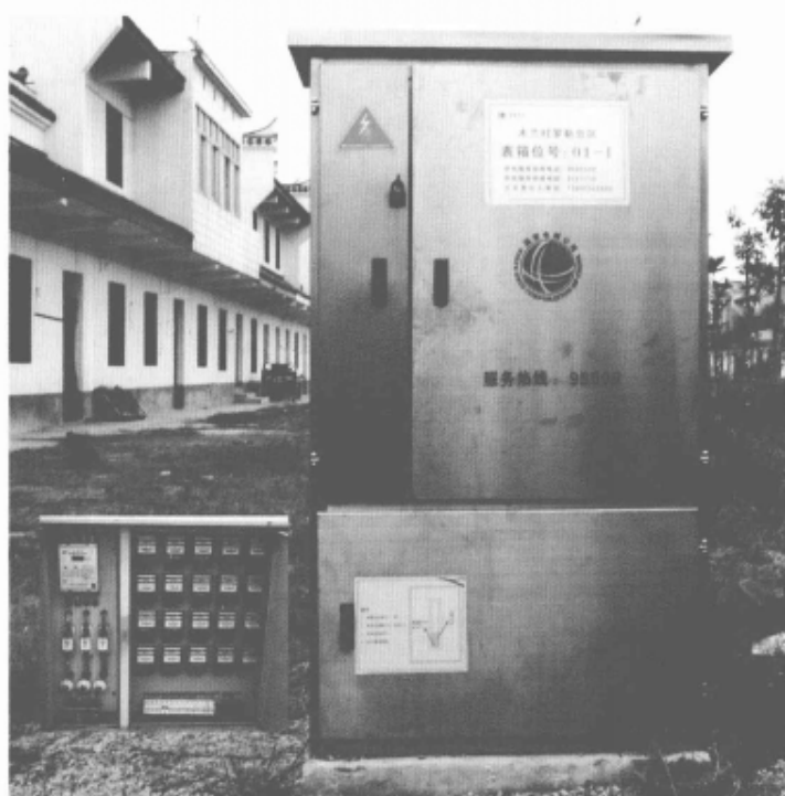
图十五 “四新”技术—落地集中式电表箱在新农村电气化村的应用
