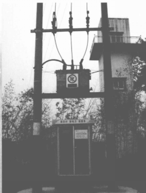
图十四 采用落地式配电箱的柱上配电变压器在新农村电气化村的应用
