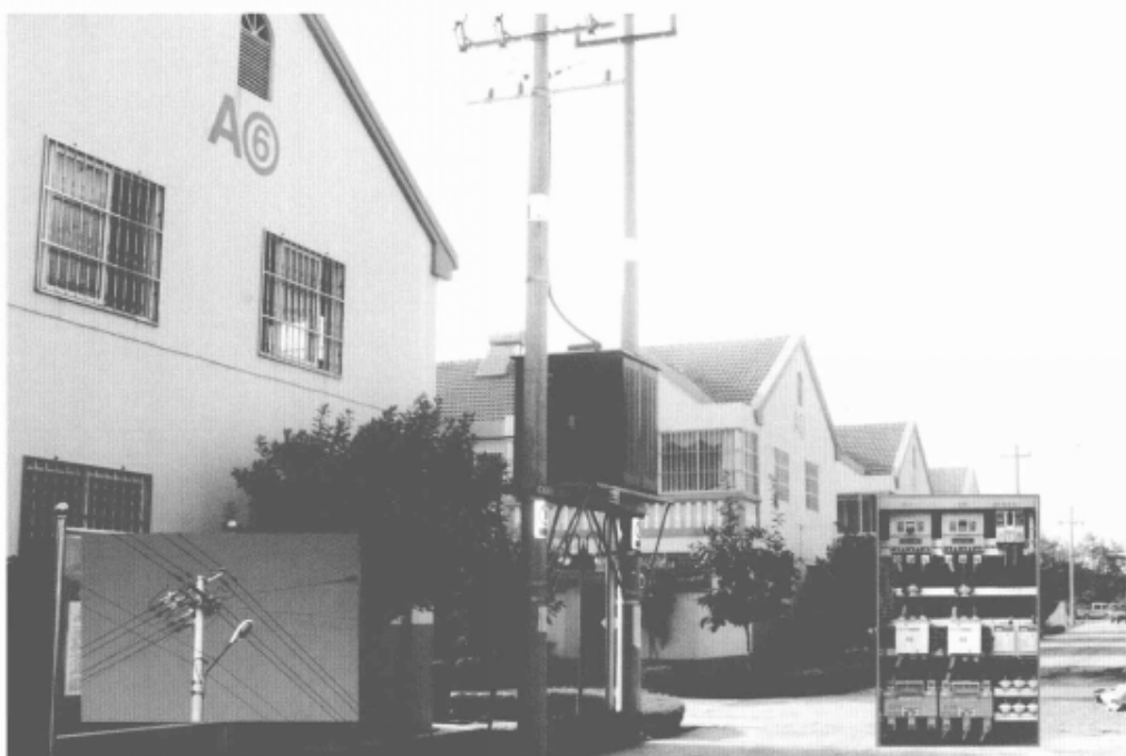
图十三 “四新”技术—智能、防雨型箱式柱上变在新农村电气化村的应用
