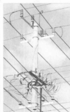
高、低压线路同杆架设及高压出线工艺
