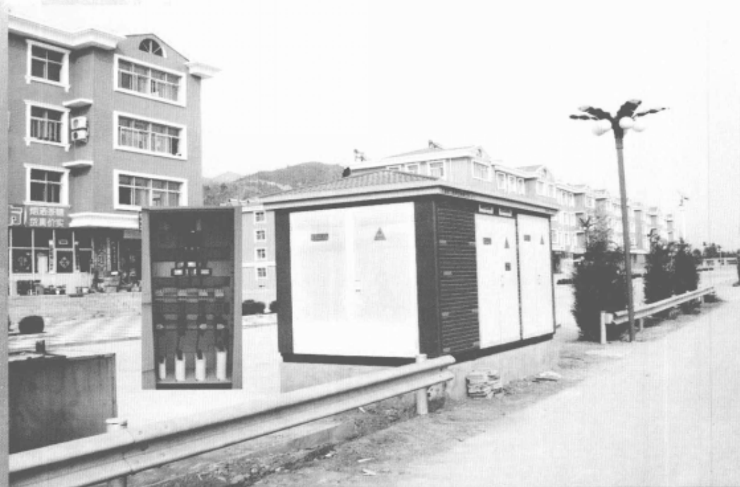
图八 采用箱式变的供电模式及自动无功补偿装置在新农村电气化村的应用
