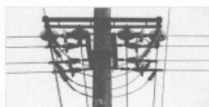
0.4kV配电线路工艺
