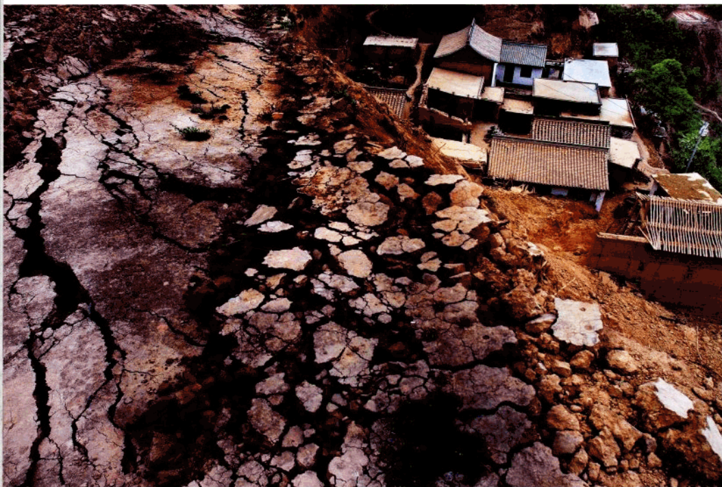
陇南市武都区安化镇甘树湾村附近的公路严重损毁，危及村庄
