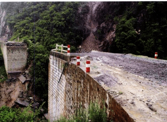
地震中严重受损的212国道螺旋沟大桥在强余震中坍塌
