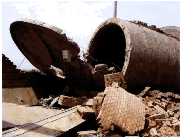
建于1997年的崇信县甘庄人饮工程水塔在地震中倒塌
