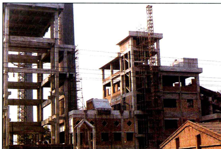
贾汪 15MWe PFBC-cc 中试电站部分厂房
