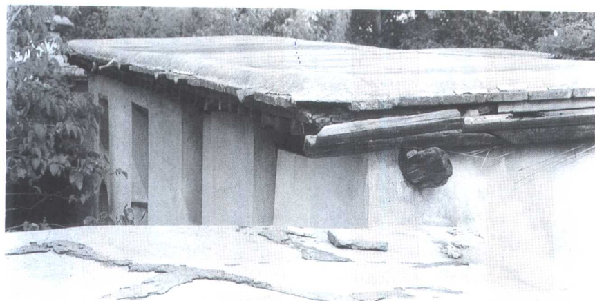
年久失修的中共中央旧址一角。
