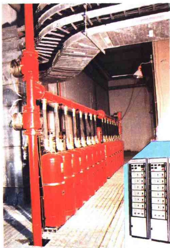
“1301”自动灭火系统工程用于电厂电缆间
