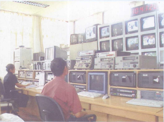
电视播控中心机房
