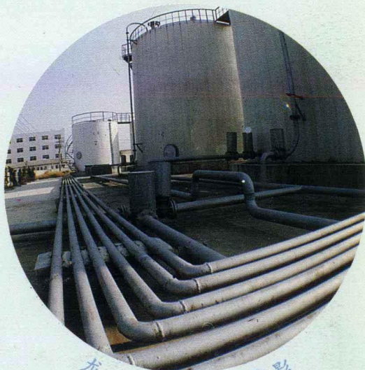
龙头山油罐区掠影
