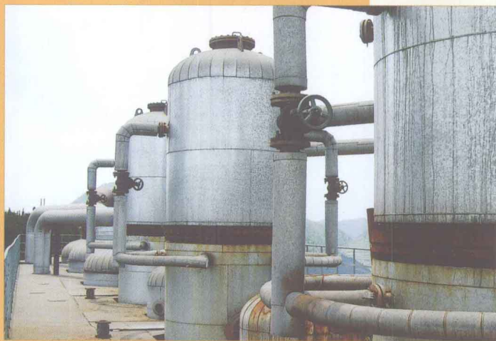
蒸发系统管式蒸发器
