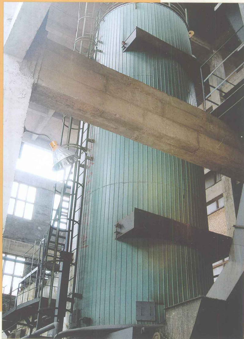
溶出车间 600 万大节溶盐加热炉
