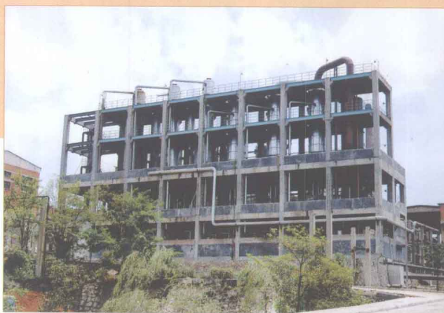
蒸发车间三管三板降膜蒸发器
