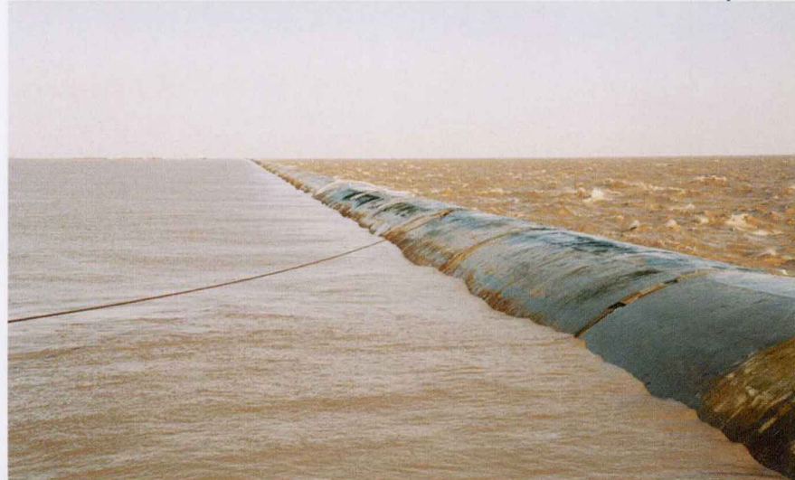
充砂半圆型沉箱混合堤（单个重量 1194t）。导堤阻挡着航道外波浪和掀沙。
