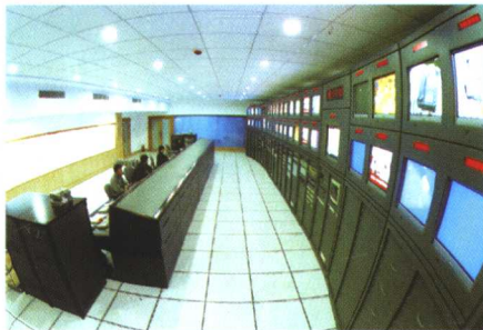
电视播出机房
