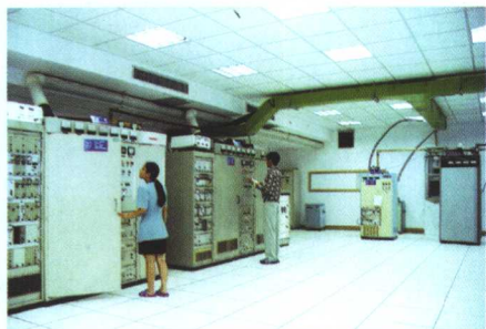
调频电视发射机房
