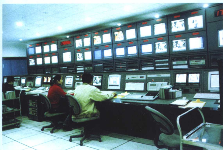
电视播出机房
