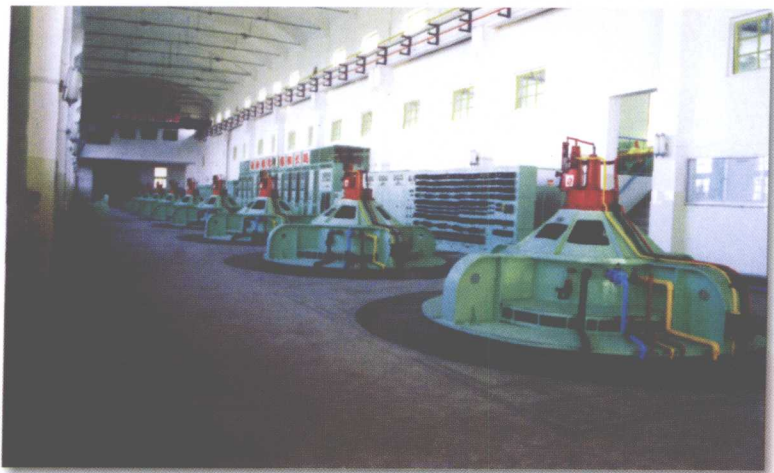
仙桃市排湖泵站装机容量 1.44 万千瓦, 受益农田 100 多万亩, 年创综合经营产值 1500 多万元, 曾获水利部、水利厅先进单位称号。
