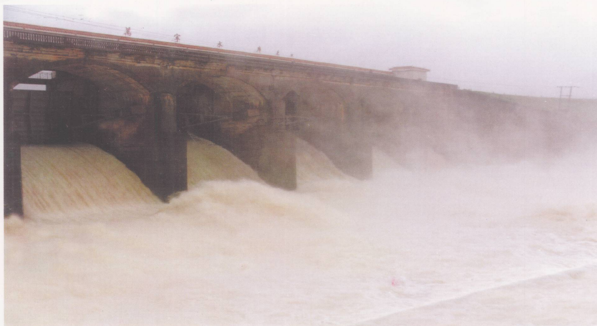
万宁水库水位超过历史警戒水位
