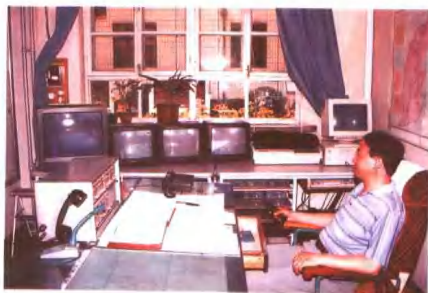
1997年段安全监控系统建成 (工会根提供)
