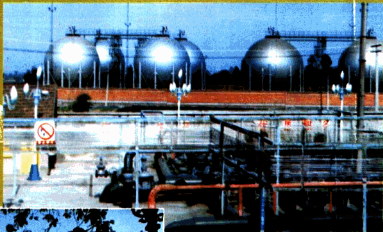
△ 天然气输供站担负着供应城区居民的生活用气任务
