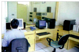
校园网总控室
