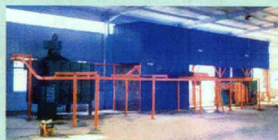
静电自动喷涂流水线
