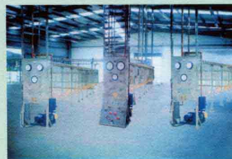
广东普莱克斯钢液工业气体有限公司广州分公司 GC2×40瓶组混合气体 1.公称工作压力: 25-40MPa GC2×40瓶组永久气体充装装置 2.水压试验: 37.5-60MPa
