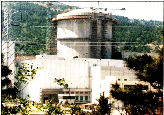
秦山核電站核島主廠房
