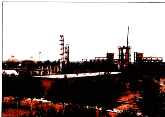
喇二壓氣站冷凍、輕油回收工段：日處理油田氣120萬方，吸水制冷工藝、制冷能力200萬大卡/時。74年開始設計、建設，76年5月份投產。
