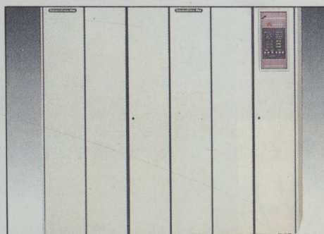
不斷電電源系統 Uninterruptible Power System (U.P.S.)
