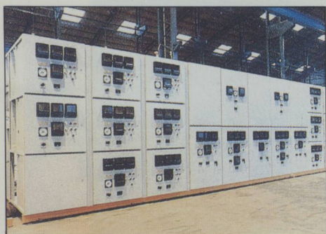
3.3KV 二層及三層式配電盤 3.3KV Metal Enclosed Switchgear
