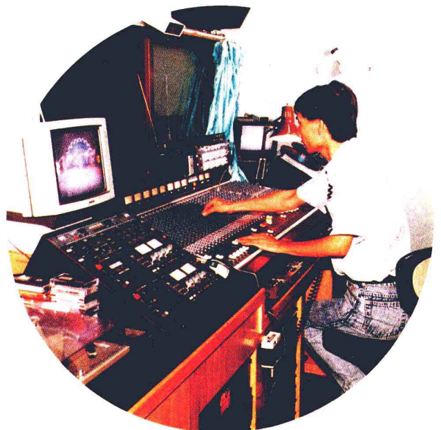
音響及閉路電視控制室
