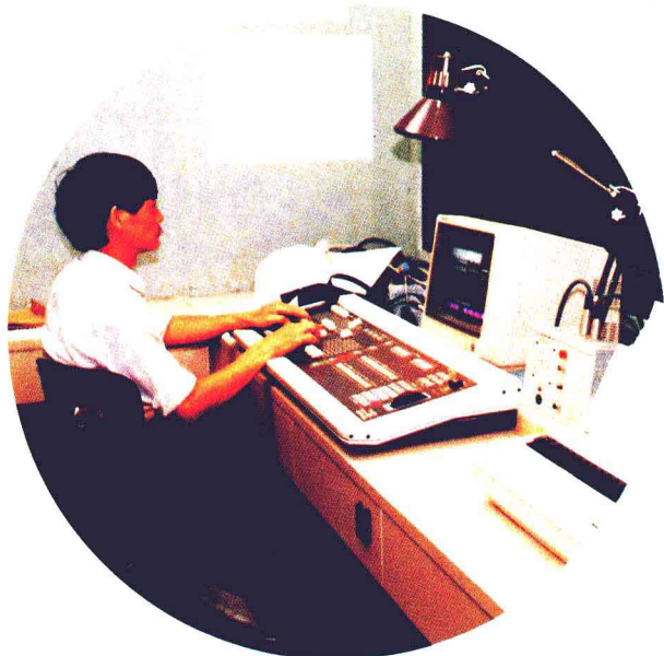
舞台燈光電腦控制室
