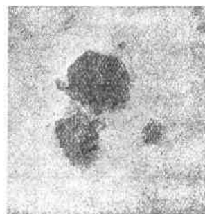
图 13 配管壁上所发生的铁瘤
