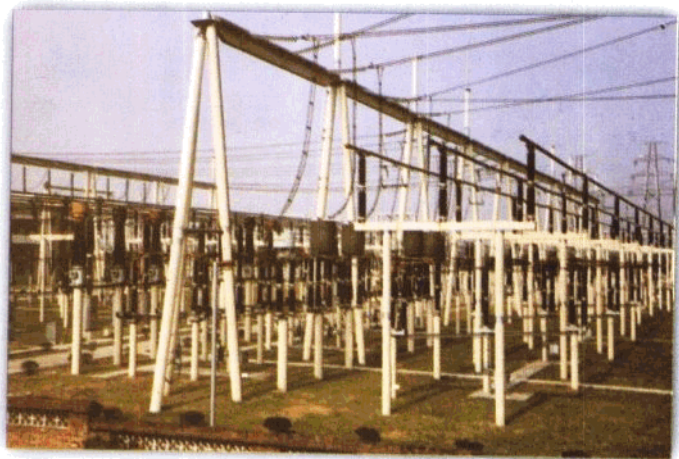
狮子田家湾220KVA变电站 (供电局供稿)
