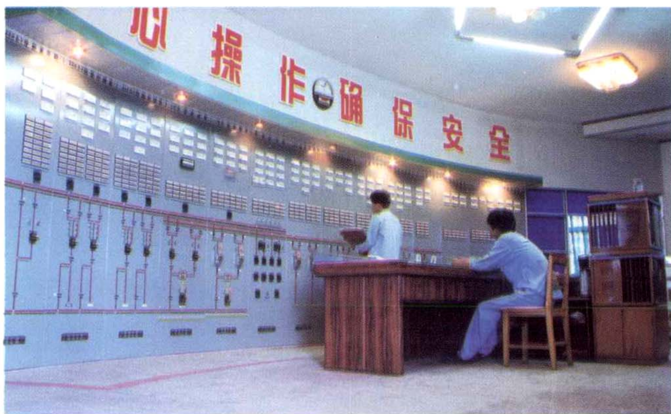
▲殷巷 22 万伏变电站操作室
