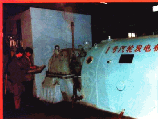
▼集中供热二期工程新建的发电机组向电网输电,取得了较好的经济效益和社会效益。
