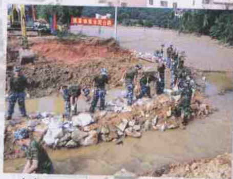
省市领导到S118线公路水毁现场视察
