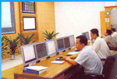
调度集控中心
