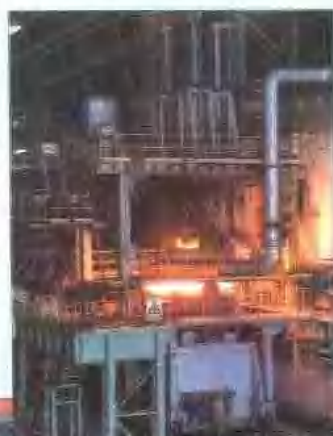
100吨真空精炼炉（LF）
