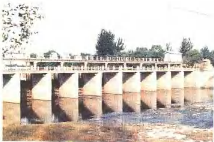
武清县龙凤河十一孔节制闸
