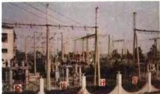
◁1981年建成的东城坑皂角山 11 万伏输变电站，装机容量为 30000KVA。
