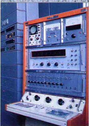
通訊中心機房
