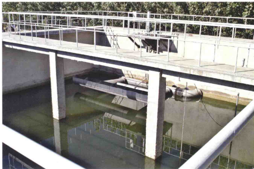
桥梓镇污水处理站
