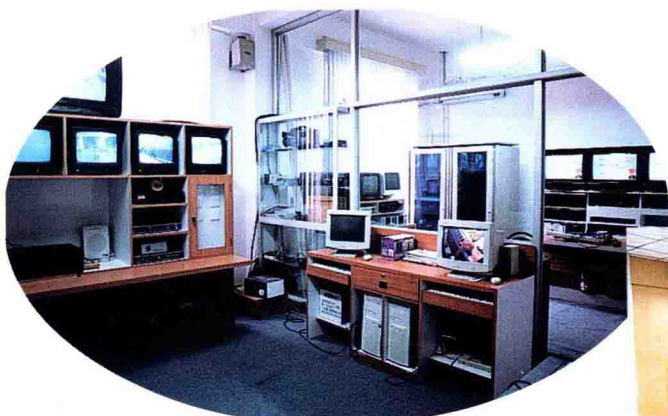
学校多媒体监控中心
