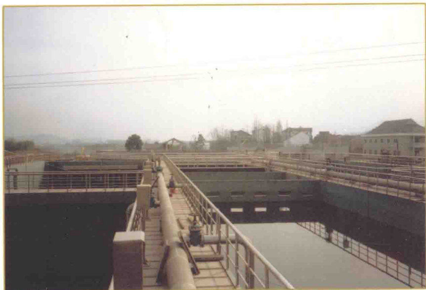
污水处理厂处理系统工艺管道、控制柜配置
