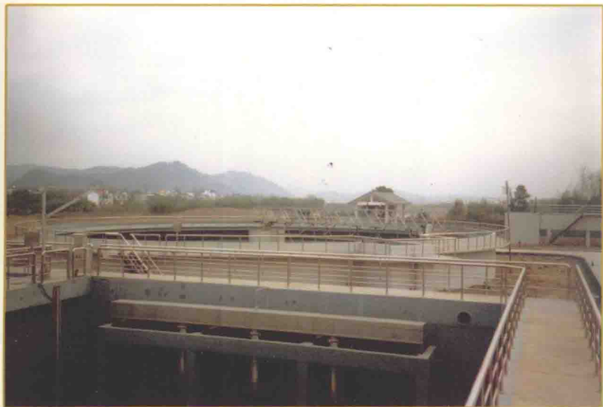
污水处理厂处理系统部分设备配置
