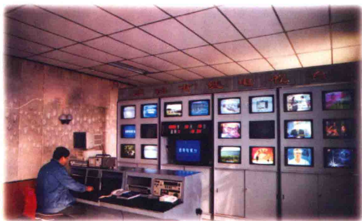
公司有线电视台值机室
