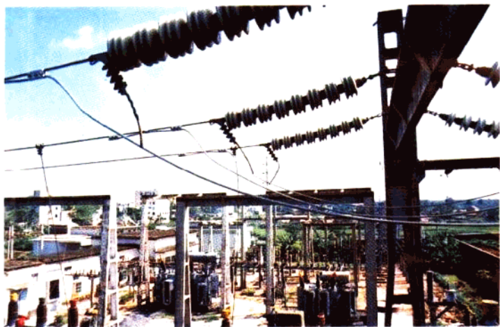
▲徐闻县城 110 千伏变电站
