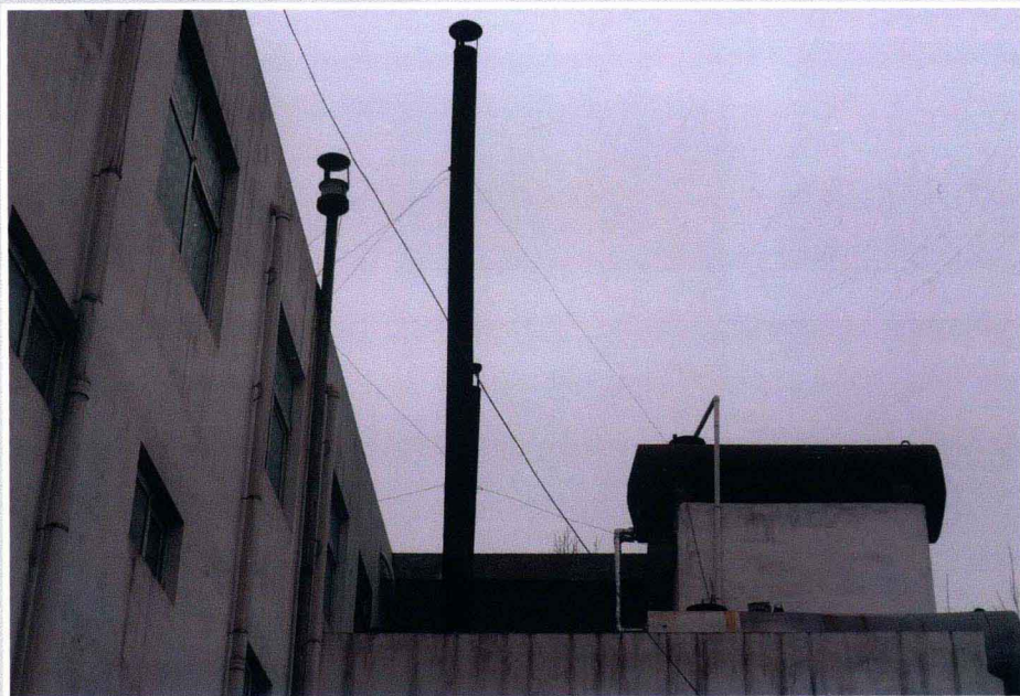
洗浴中心的手烧锅炉 拍摄于2012.02.15
