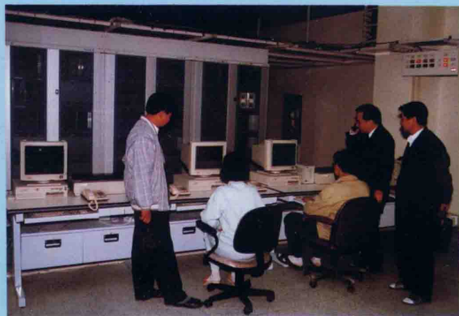
梅县邮电局新建的万门程控电话机房
