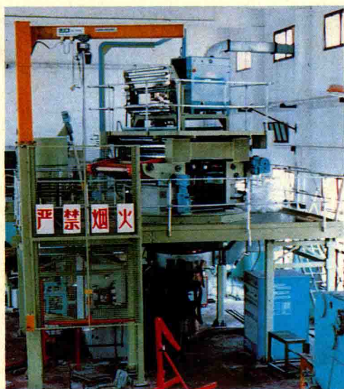
浙东化工二厂(浙东透明纸厂)从意大利引进的PVC扭结膜生产线主机。
