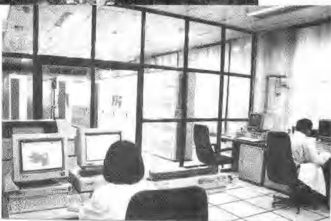
程控电话机房
