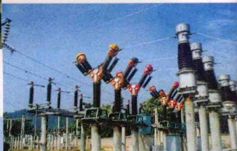
△西桥110千伏变电站
