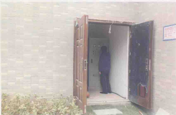
高楼用水二次加压供水系统泵房
