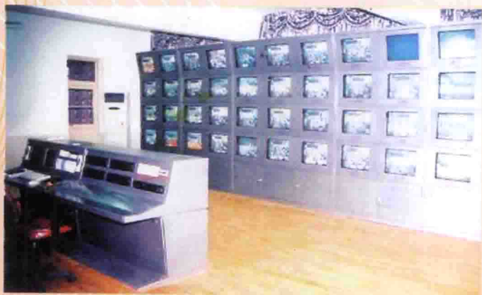
三峡高中监控室
