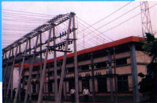
供电车间一角
