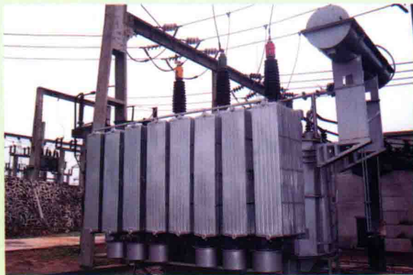
新陂 110 千伏变电站 SFSZ8-31500/110 有载调压变压器
