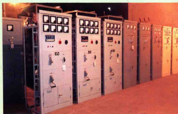
兴宁电气控制设备厂是两部鉴定的粤东地区电气控制设备专业生产厂。生产的电器控制屏高压开关柜等 10 多种产品深受用户欢迎。
