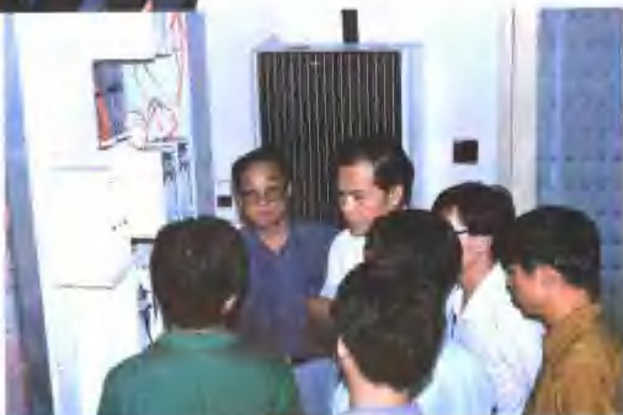
1992 年 7 月 14 日邮电 部副部长杨贤 足(左三)视察 南沿海光缆工 程松江机房
