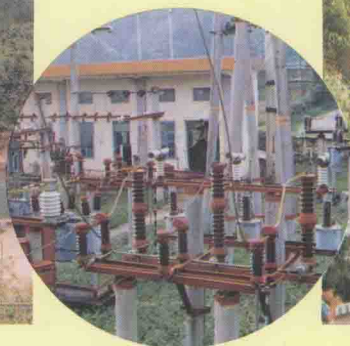
坑口镇变电场
