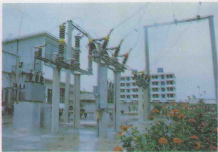
35 千伏问安变电站一角
