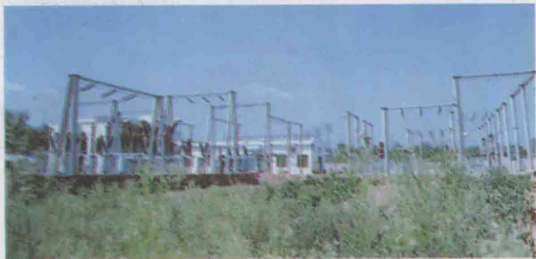
一百一十千伏百里洲变电站外景
