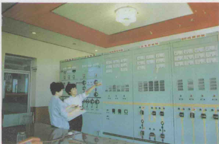
35 千伏董市变电站值班员在工作中
