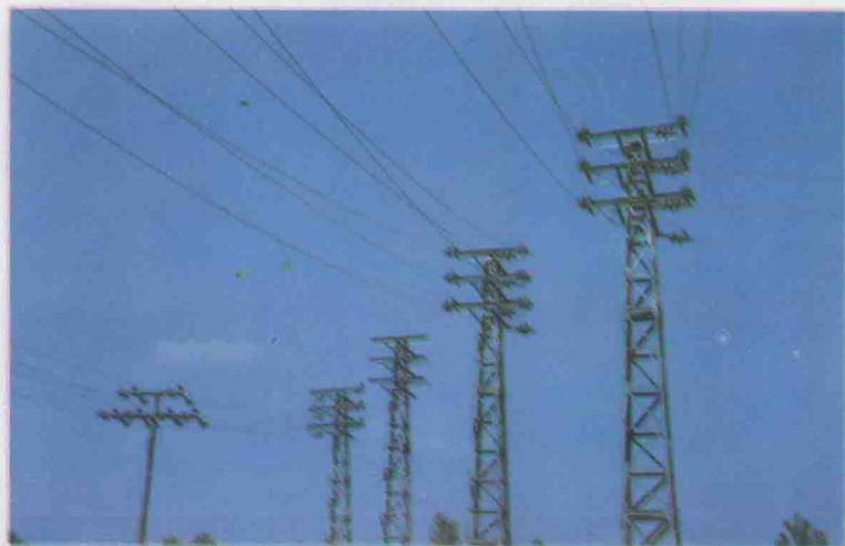
铁塔巍巍，将电力送往四面八方
