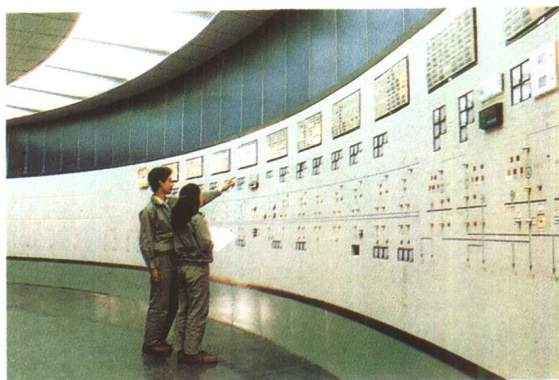
上海外高桥电厂主控室
