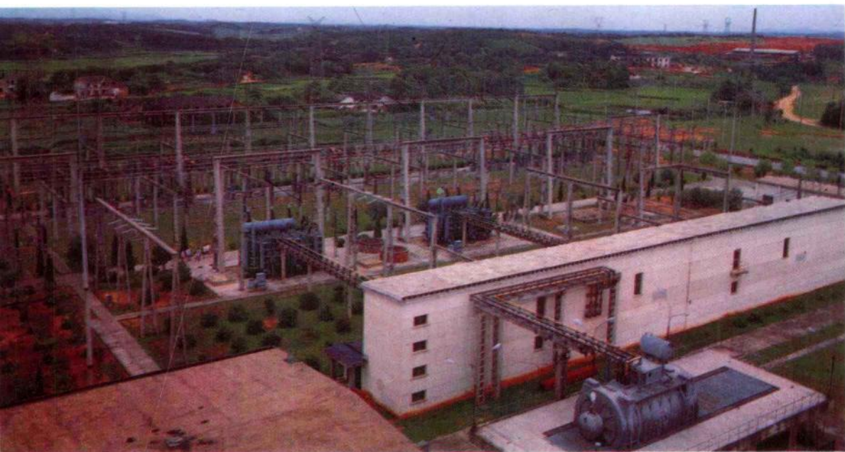
聯絡省內西南北電網的樞紐站——槩梨220千伏變電站
