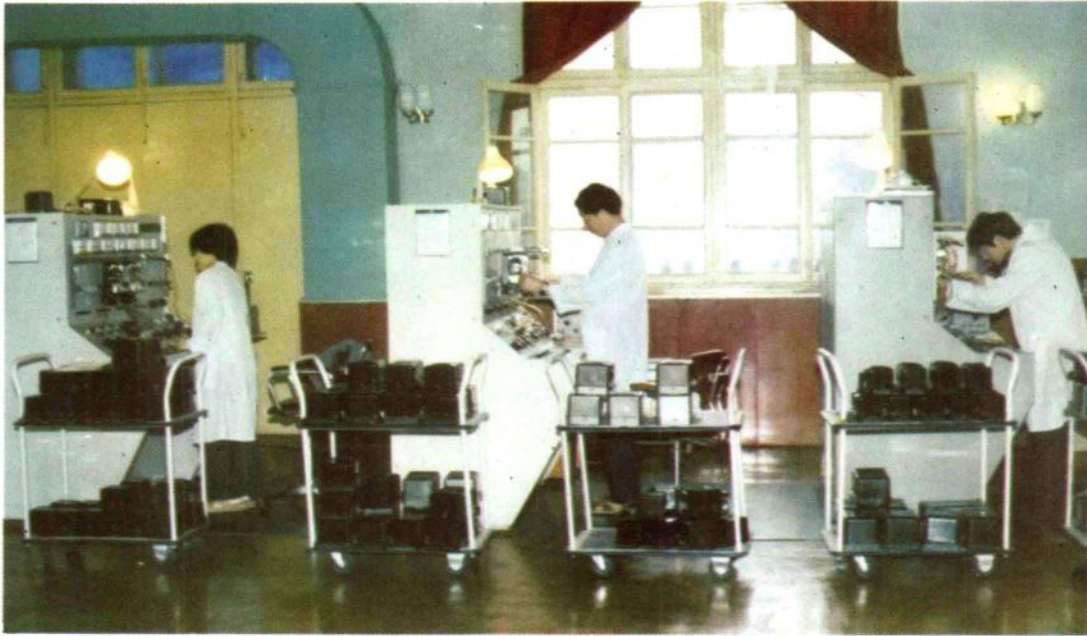
具有先進檢測手段的電能計量室
