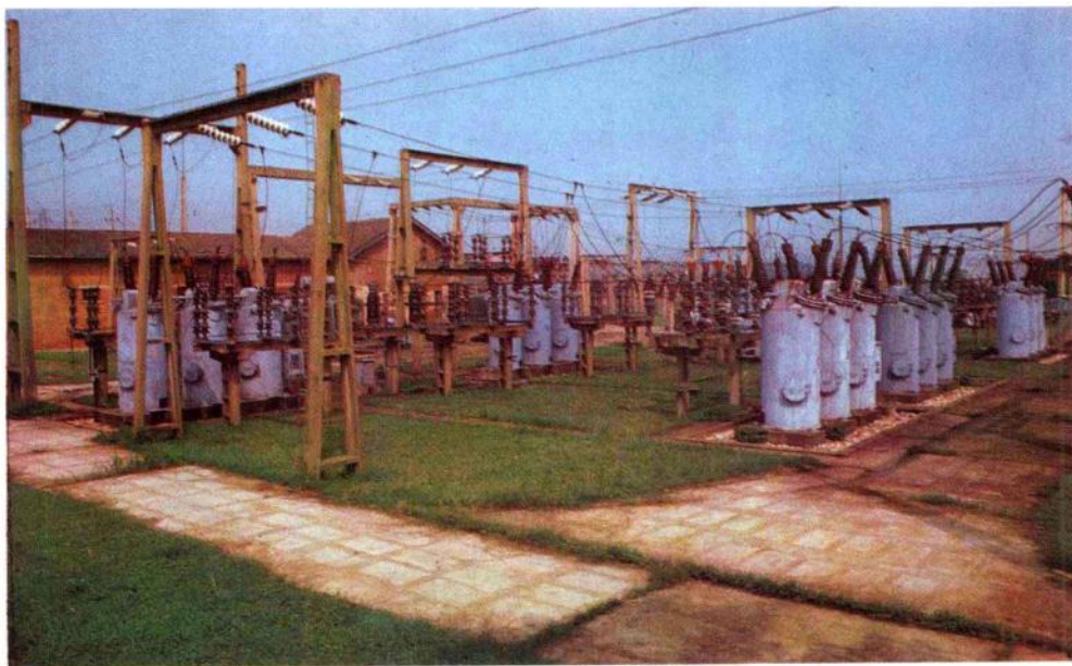
長沙地區第一座110千伏變電站——樹木嶺變電站於1960年2月投入運行
