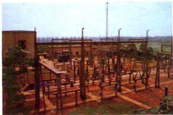
長沙地區第一個採用小車式開關櫃的110千伏 ——石嶺塘變電站
