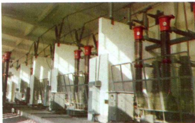
長沙地區第一座使用戶內式油開關 的——窑嶺變電站
