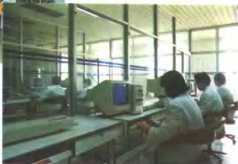
程控电话机房
